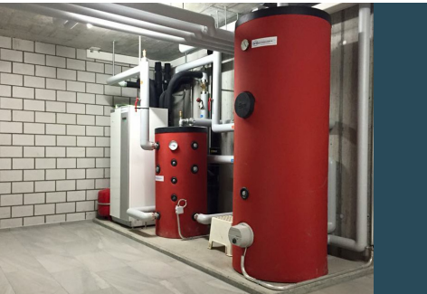
Heizzentrale eines Mehrfamilienhauses in Kastanienbaum mit Sole/Wasser Wärmepumpe
