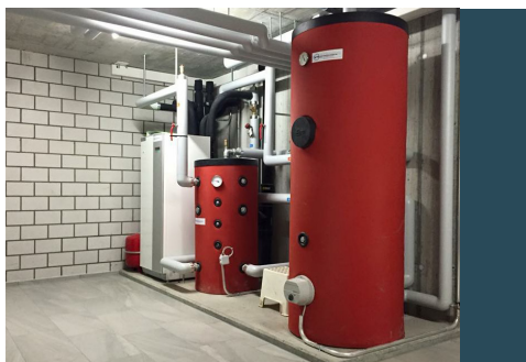
Centrale de chauffage d'une maison multifamiliale à Kastanienbaum avec pompe à chaleur sol-eau.
