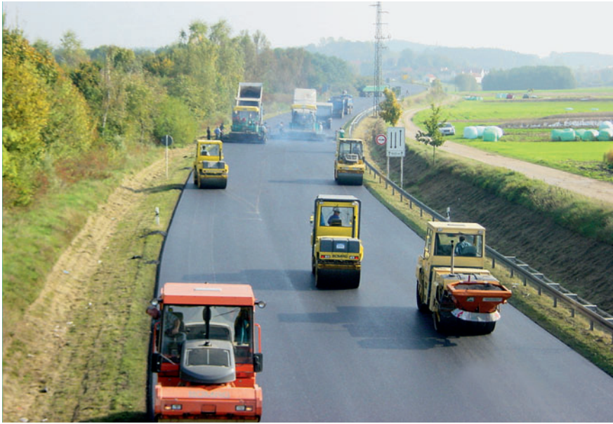
Die Asphaltkolonnen des Straßen- und Tiefbauunternehmens Franz Schelle GmbH & Co KG hier bei Arbeiten in Langenbruck
